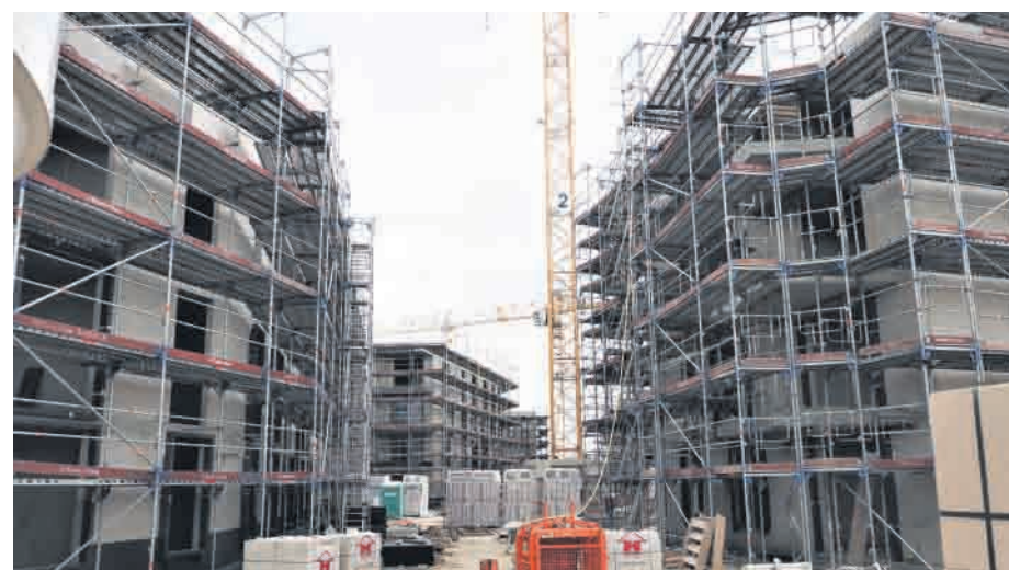
Noch sieht es an der Giselbertstraße sehr nach Baustelle aus, aber das wird sich sehr schnell ändern. Die Visualisierung gibt einen Eindruck, wie es dort nach der Fertigstellung aussehen wird. Im Frühjahr 2022 sollen die ersten Mieter einziehen.
